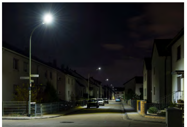
Mitarbeiter der Pfalzwerke Netz AG haben die Leuchtmittel von 25 Straßenlaternen im pfälzischen Maxdorf für den Feldtest gewechselt. Sparsame Mid-Power-LEDs sorgen nun für bessere Ausleuchtung im Musikerviertel.
